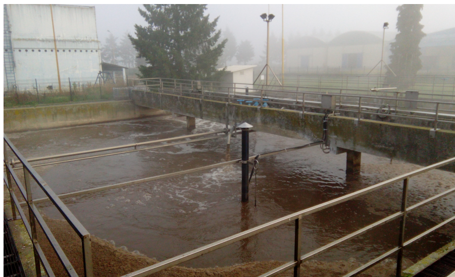
Slika 1.20. Aeracijski bazen s aeratorom pričvršćenim za metalni nosač
