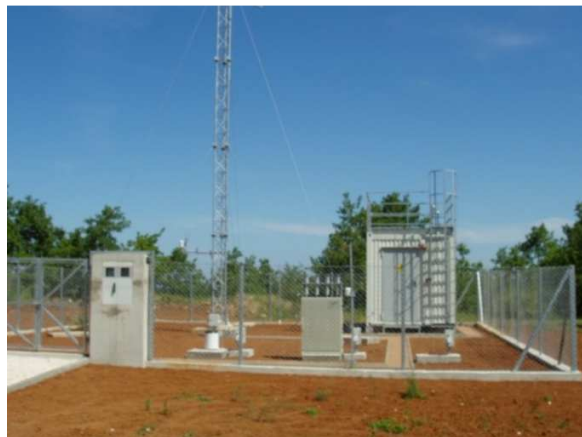
Slika 3.1.1.1. Fotografija automatske mjerne postaje Višnjan [12]
