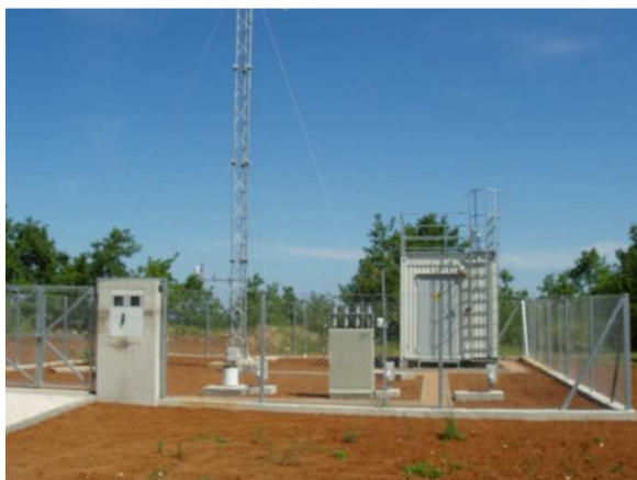
Slika 3.1.1.1. Fotografija automatske mjerne postaje Višnjan [12]
